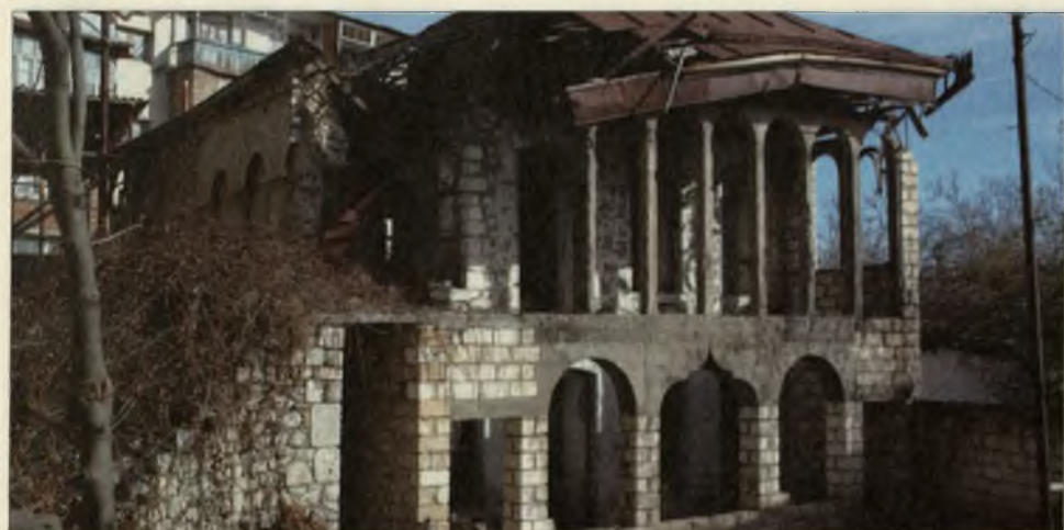
Dağıdılmış yaşayış binası
